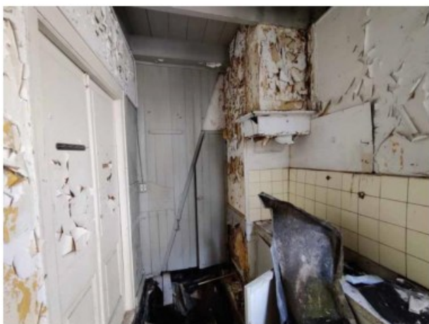
Figuur 4 Rommelhoop in het pand
