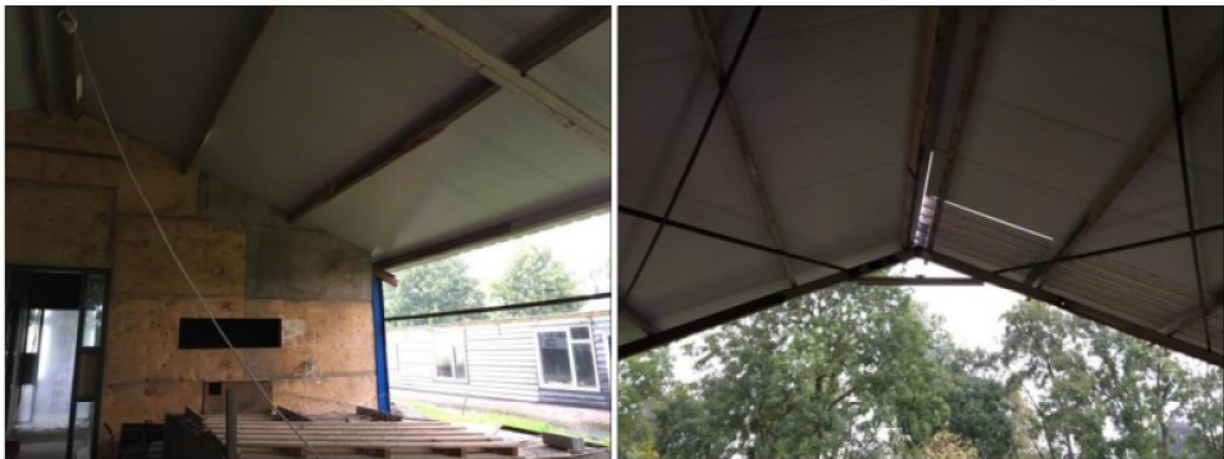
Potentiële nestlocatie van vogels onder de te slopen overkapping.
