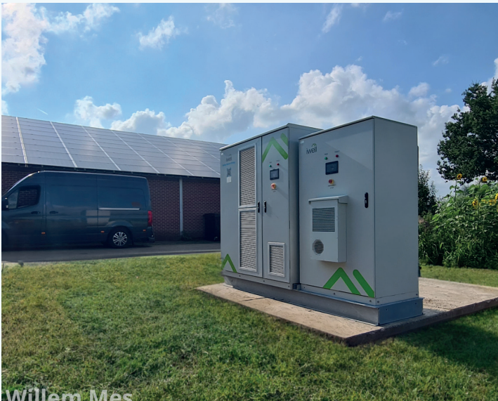
^ Projectbatterij bij zon op dak
