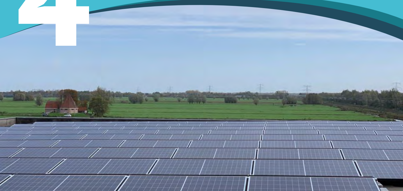
Zonne-installatie met ca. 3000 panelen op het bedrijfsdak van Groenendijk Bedrijfskleding
