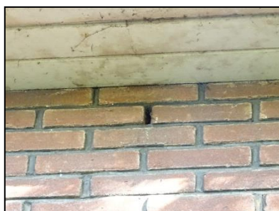
Figuur 7. Een van de open stootvoegen in de woning.
