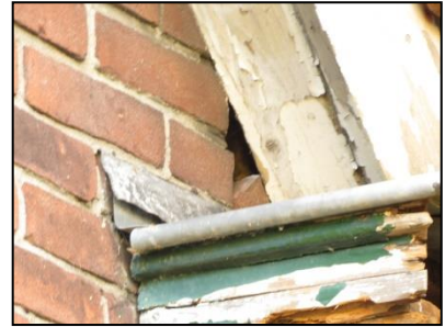
Figuur 11. Open gat in de muur van de woning.
