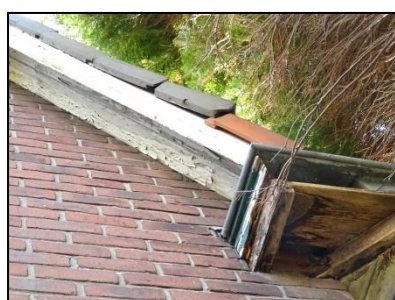
Figuur 6. Ruimte onder dakpannen en openingen in dakgoot van de woning.
