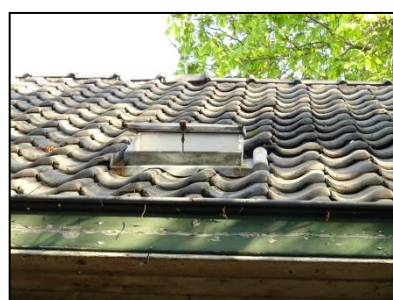
Figuur 8. Los zittende dak- en nokpannen van de woning.
