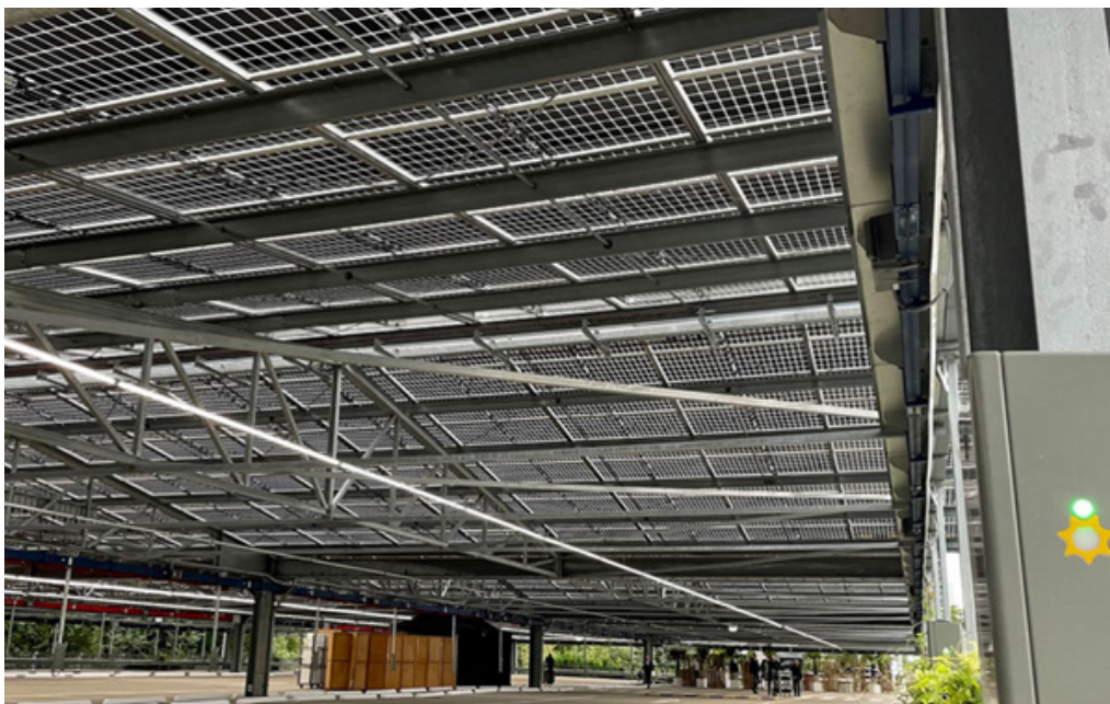
Het grootste bi-directionele laadplein ter wereld, bij a.s.r. aan de Archimedeslaan in Utrecht, waar 250 elektrische auto's tegelijkertijd kunnen opladen en ontladen, geopend op 15 september 2021
